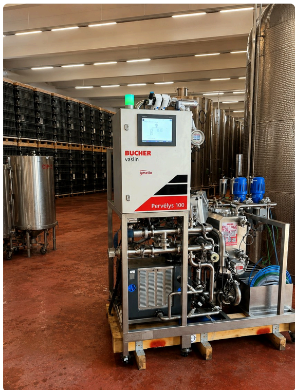
Pervélys™ 100 Unité standalone — installation en cave 143 m² membrane · Hasta 10.000 l/h*
